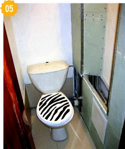
05 На пол и стены уложил плитку. Стену со стояком и трубами обшил гипсокартоном.
